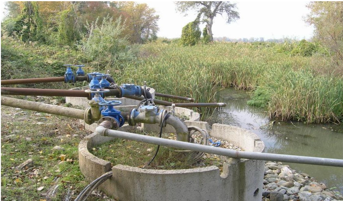
Εικόνα 2.5: Αντλιοστάσιο με τρία αντλητικά συγκροτήματα στην θέση «Παλιοβόρια» στην παλαιά κοίτη του Πηνειού ποταμού
